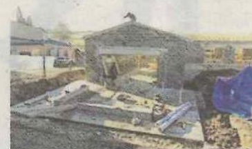
Les bâtiments d'extension de l'école et de création d'un ALSH : le gros œuvre est quasiment terminé.
